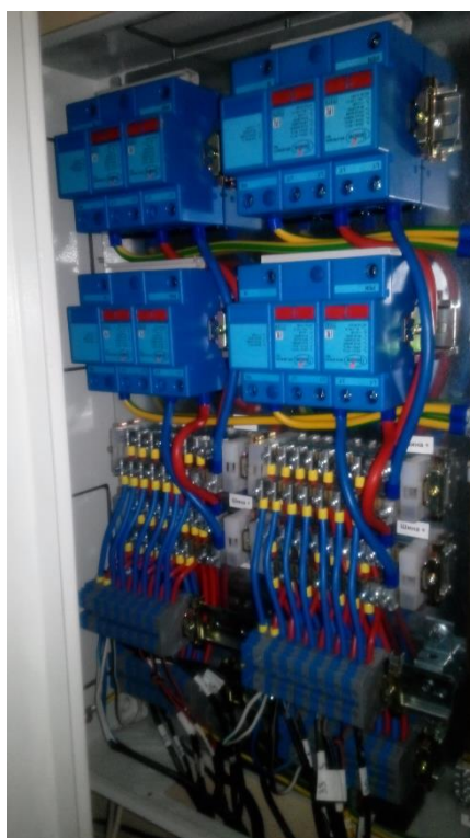
Рис.11 ЩЗИП для защиты блоков питания видеокамер
