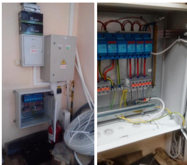
Рис.13 ЩЗИП для защиты оборудования КИТСО со стороны электропитания
