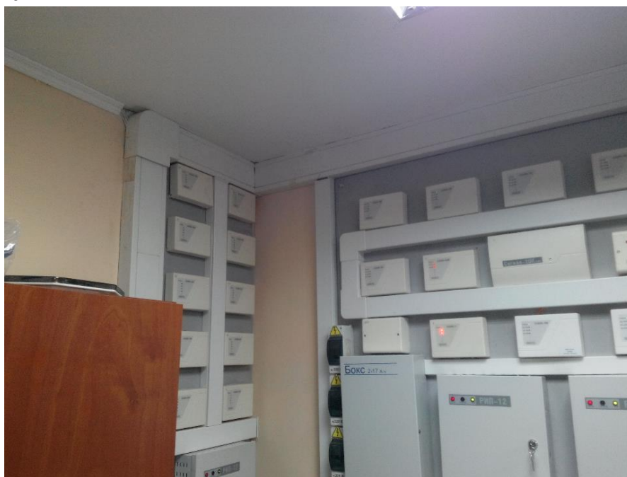
Рис.5 Блоки ОПС в помещении аппаратной
