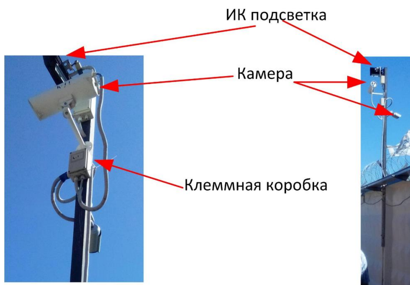
Рис.3 Пример установки ИК подсветки и ВК
