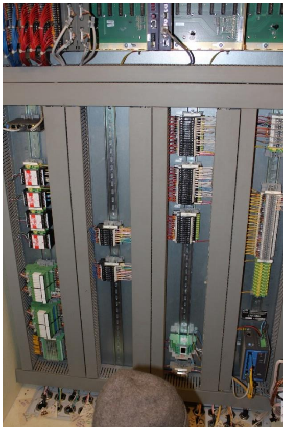
Рисунок 4 – Внешний вид шкафа телемеханики при раскрытых дверях
